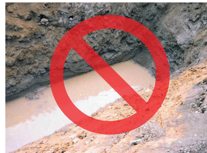
Niveau d'eau dangereux
