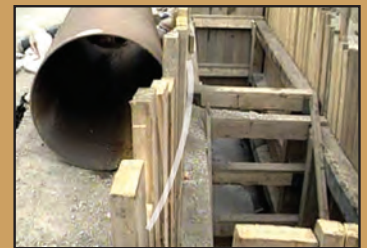
Déformation des parois
