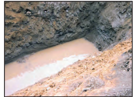
Niveau d'eau dangereux
